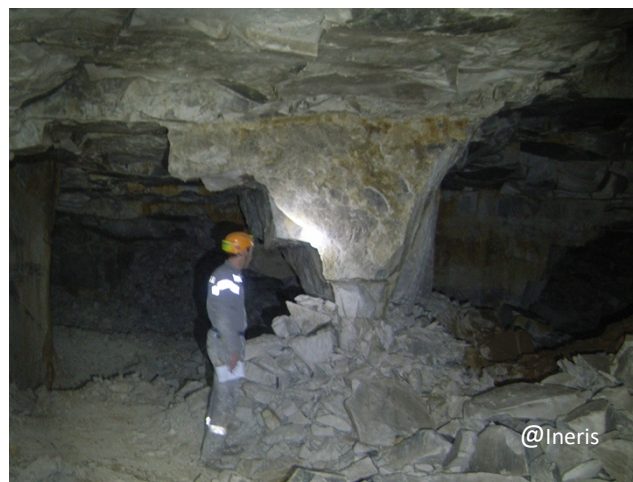
Figure 8 : Pilier très dégradé n'assurant plus sa fonction de maintien dans une carrière de la région lilloise
