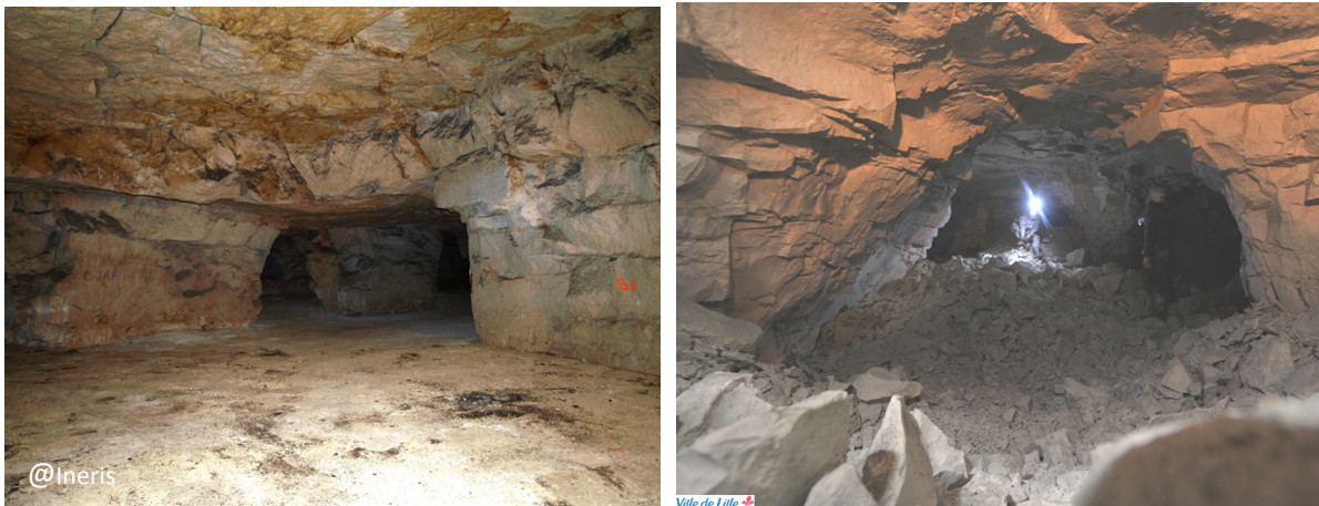
Figures 11 : Illustration de deux carrières souterraines de conditions d'acheminement opposées (aisé à gauche dans une carrière de calcaire de l'Oise, difficile et dangereux à droite dans une carrière de la région lilloise)
