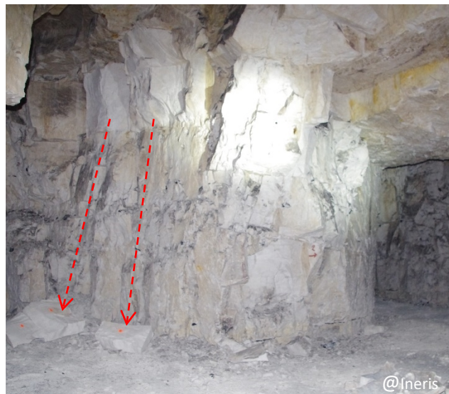
Figure 3 : Un exemple de pilier dégradé dont l'évolution pourrait être suivie (Hauts-de-France)
